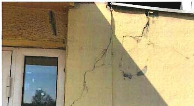
Slika 1. Karakteristično oštećenje: Pukotine u ab stubovima i zidovima starog objekta.
